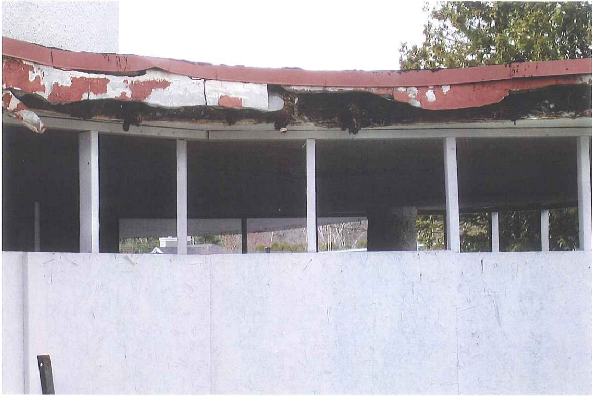
Petite marquise endommagée (vue extérieure)
