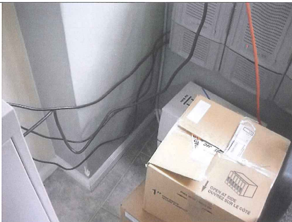
Photo 5 – Plâtre sur le mur périphérique réception. (Présence amiante)
