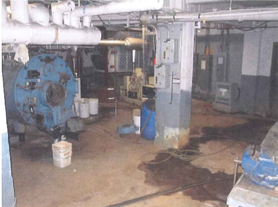
Photo 8 – Réseau mécanique de chauffage et d’eau chaude. (amosite)
