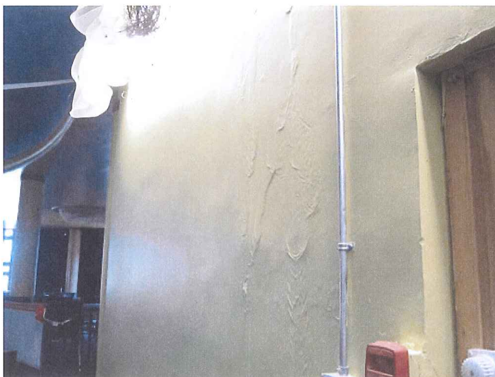
Photo 4 – Salle de Bal 3 e étage (plâtre d'amiante)
