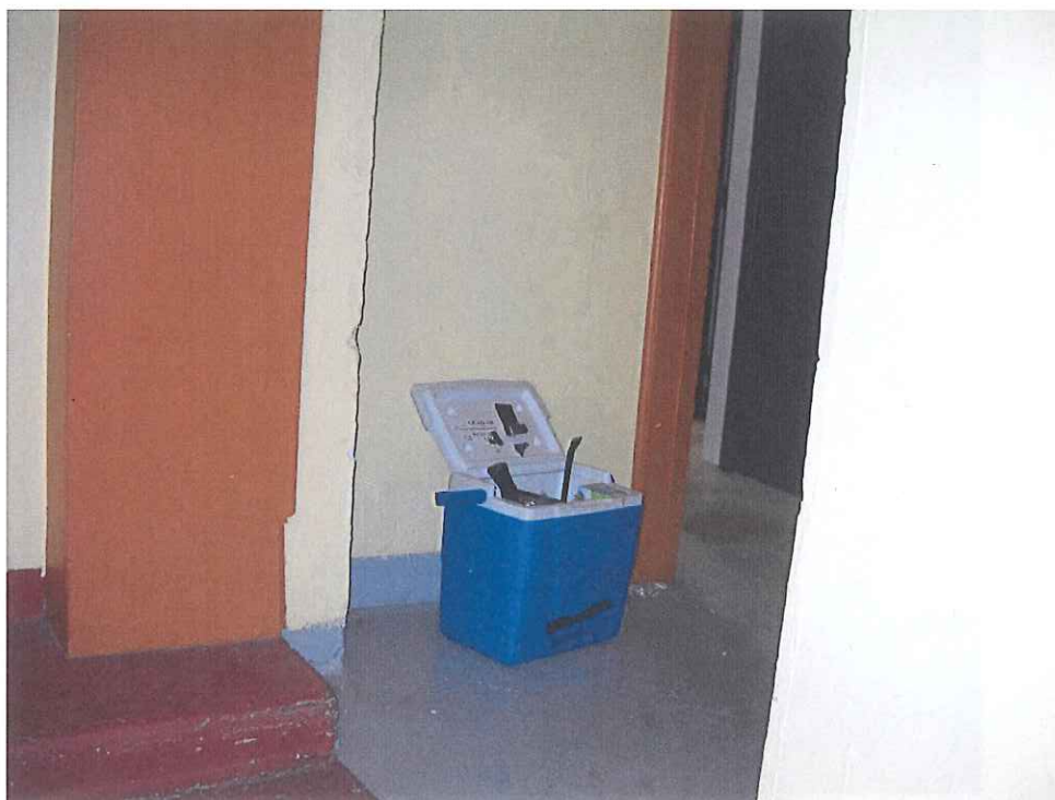
Photo 6 – Colonne au RDC (Présence d'amiante)
