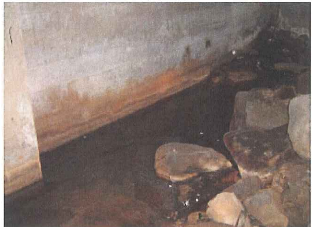
Eau stagnante en périphérie des fondations à cause de la nappe phréatique
