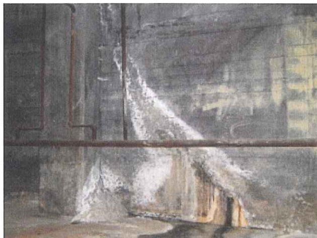
Fissure dans le mur de fondation
