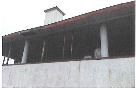
Déformations de la toiture de la terrasse
