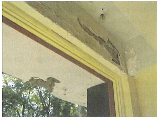
Infiltration d'eau à l'intérieur du centre d'entraînement
