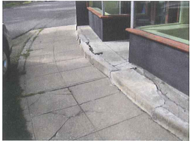
Partie surélevée à côté du trottoir qui est fissurée
