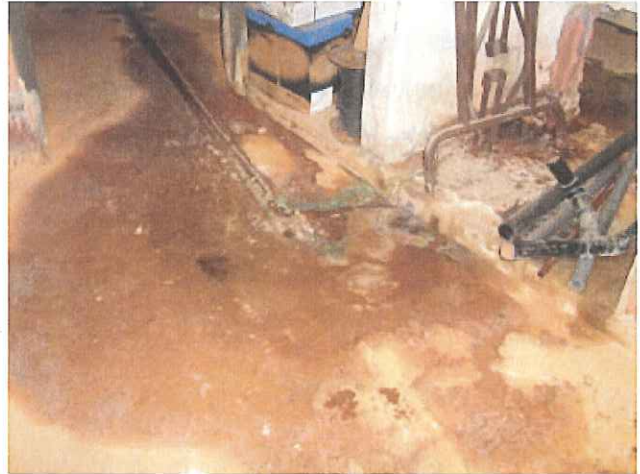
Infiltration d'eau à travers de la dalle sur sol
