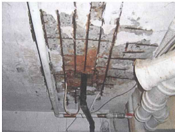
Barres d'armatures exposées au plafond du sous-sol.
