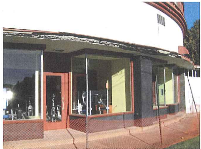
Délamination au périmètre de la marquise et colonnes à dégarnir et évaluer pour réparations éventuelles.
