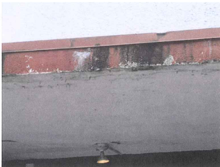
Photo 5 – Traces de contamination fongiques sur les revêtements extérieurs de l'édifice
