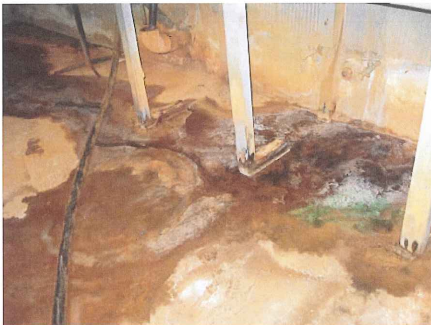
Photo 1 – accumulation d’eau et traces d’infiltration d’eau au sous-sol dans la salle des chaudières
