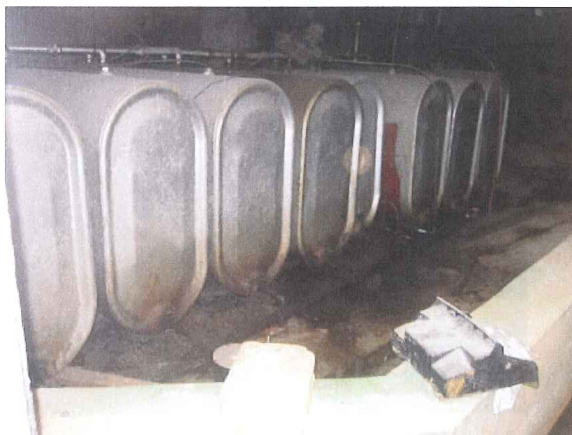
Photo 4 – Entreposage de réservoirs d’huile avec bassin de rétention muni d’un système de trop plein qui pourrait pomper les mélanges d’huile et eau vers un regard dont la destination n’est pas connue
