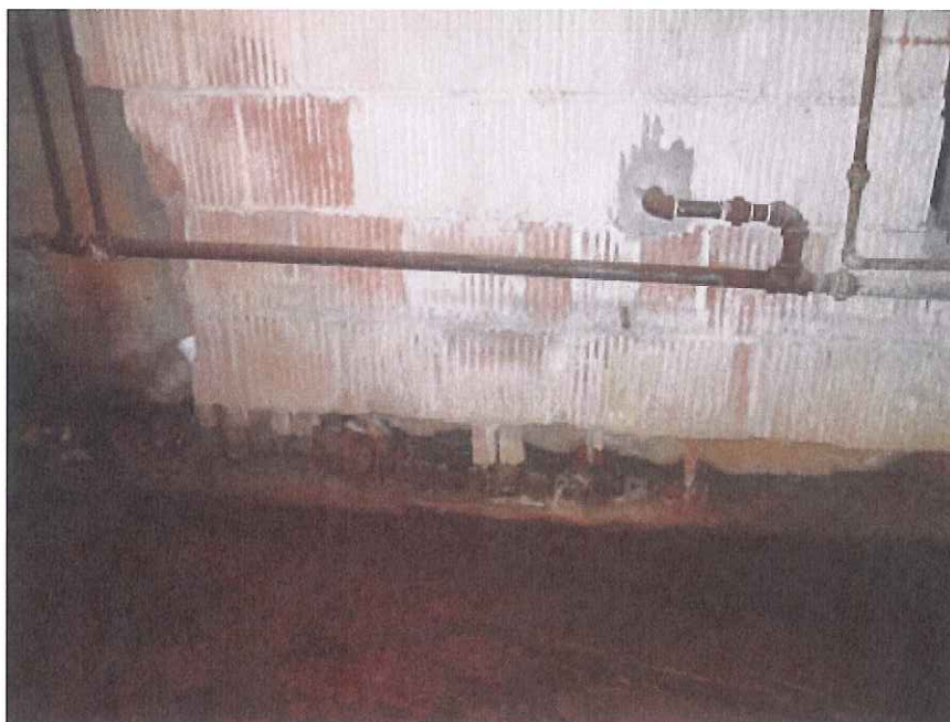
Photo 3 – Infiltration d’eau au sous-sol près de l’aire de boxe
