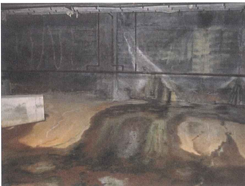
Photo 2 – accumulation d’eau et traces d’infiltration d’eau au sous-sol dans la salle d’entreposage d’huile
